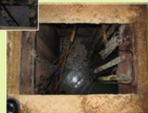
活性化したバイオ槽
