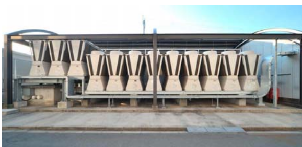
小野工場 ヒートポンプチラー。
