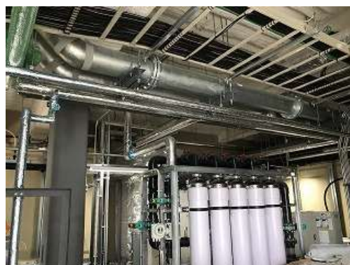
井水ろ過装置
