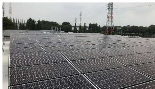
屋上に設置された太陽光ソーラーパネル
