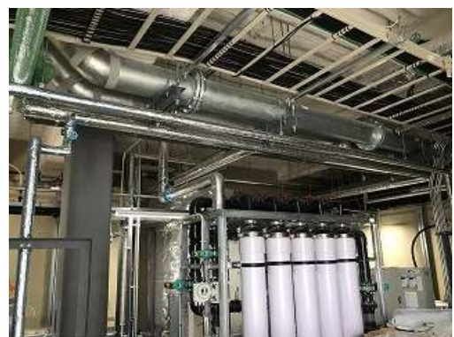
井水过滤装置
