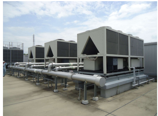
水蓄热系统的空调冷却器(土岐事业所)
