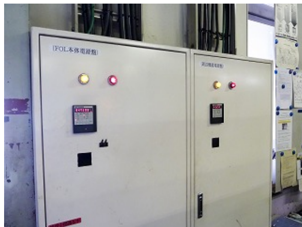
FOL-3015AJの電源部にはパワーメーターが取り付けられ、リアルタイムで使用電力量をモニターしている
