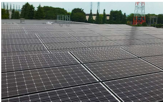
防災エネルギーセンター屋上の太陽光パネル (伊勢原事業所)
