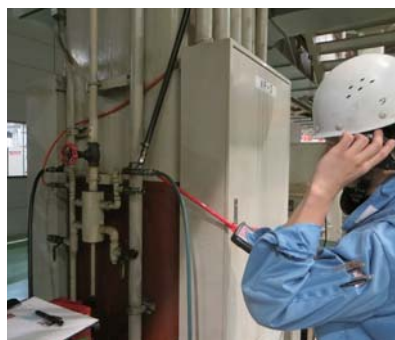
气体泄漏巡视(富士宫事业所)
