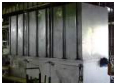
焼き戻し炉の断熱を推進(三木工場)
