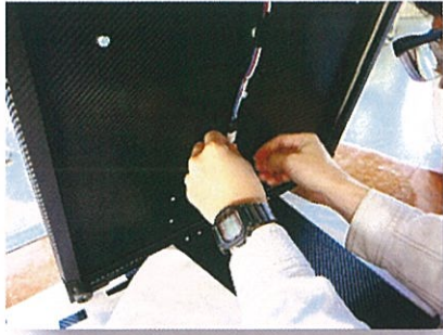
調光コントローラー取付け
